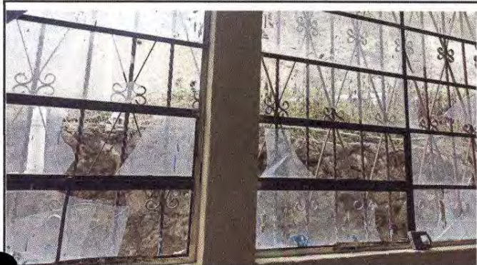
Foto 7: Sustrucción de Vidrios en ventanales de metal por deterioro
