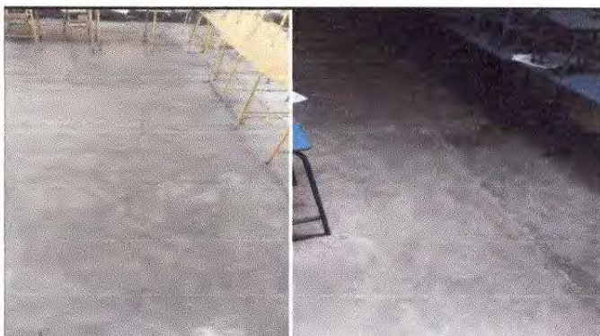
Foto 9: Sustrucción de piso cerámico
